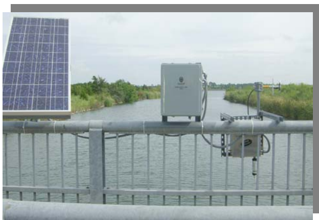
発電所排水河川 (ソーラー電力・無線通信)
