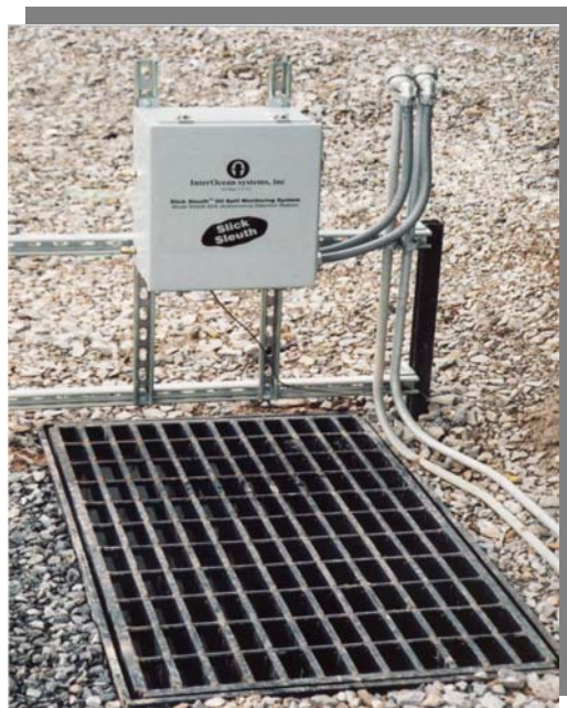
自動検出・自動ポンプ遮断システム
