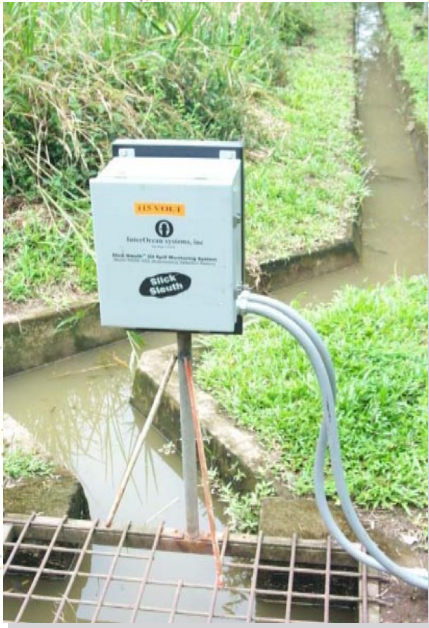
製油所構内排水溝
