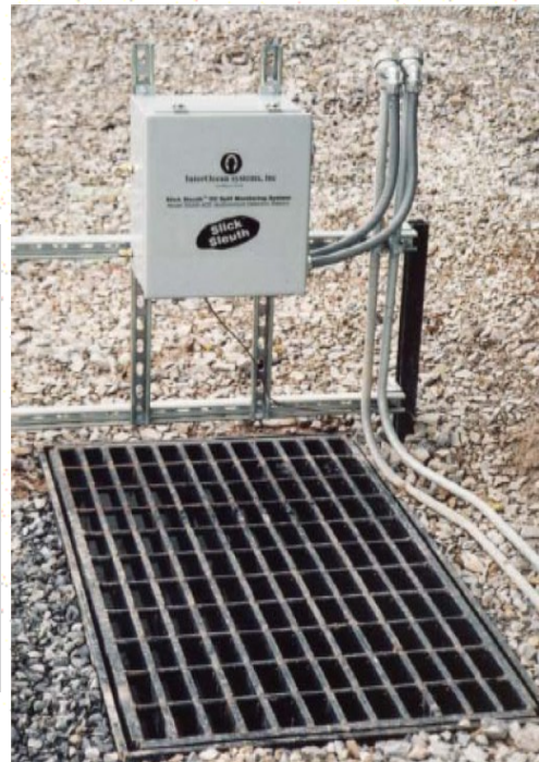
自動検出・自動ポンプ遮断システム
